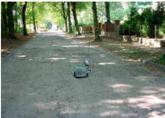
Bild 14: Tragfähigkeitsmessung mit dem Leichten Fallgewichtsgerät auf einer alten sandgeschlämmten Schotterdeckschicht ( E_{vd\ 10\%-\text{Quantil}} = 60 \text{ MN/m}^2 )
